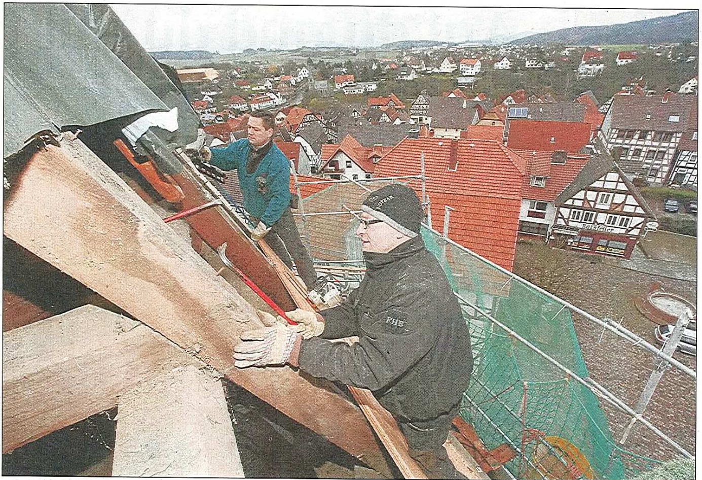
In luftiger Höhe: Die Zimmerleute Mike Brause und Thomas Hähnchen bringen an der Ostseite der Kirche die Dachschalung an, auf die die Dachdecker die Schiefertafeln nageln.
