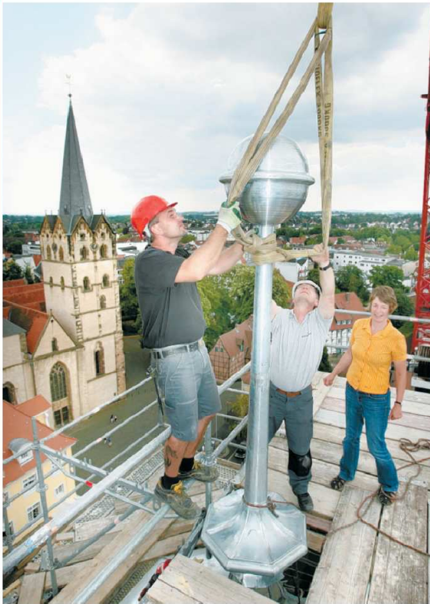
Bauarbeiter am Stiel: Gerüstbauer Evgenij Möhser, Vorarbeiter Ralf Israel und Bauleiterin Frauke Meschede freuen sich über den „Kaiserstiel“ als Vollendung der neuen Turmspitze. FOTO: KIEL-STEINKAMP
