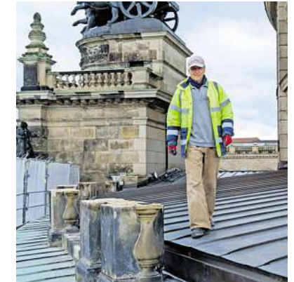
Vorarbeiter Andreas Kittell von der Denkmalpflegefirma Fuchs+Girke auf seiner Baustelle an der Dach-Balustrade auf der Elbseite der Semperoper.
